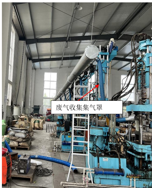
图 3-4 注塑废气收集管道照片
