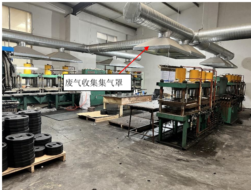
图 3-2 包胶废气收集管道照片
