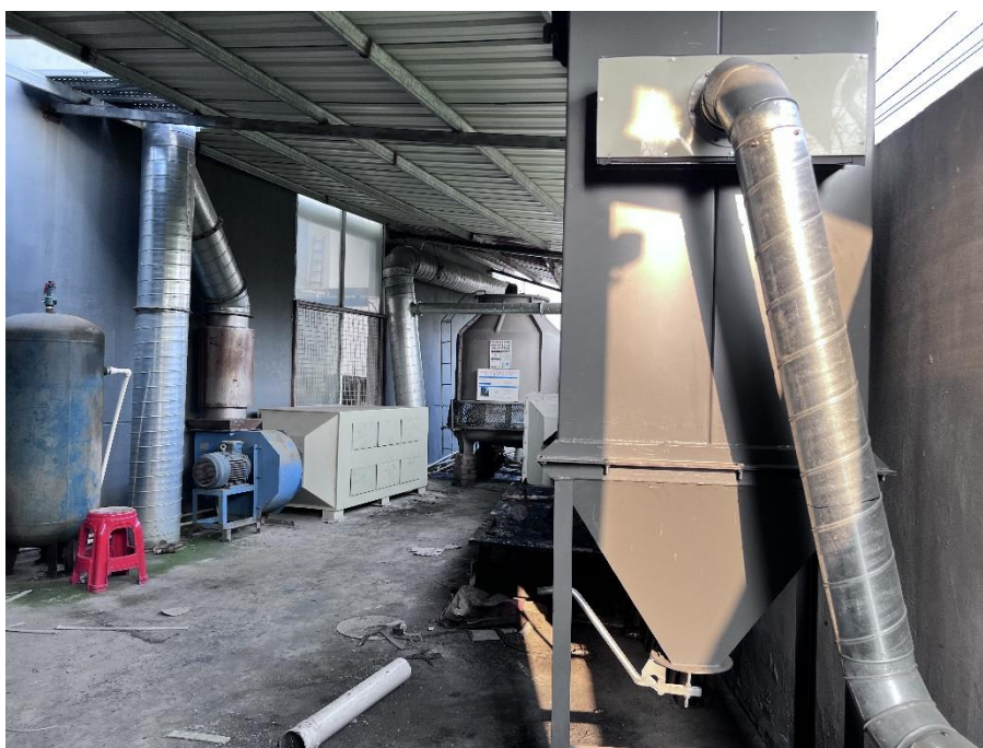
图 3-4 刻商标废气、注塑废气处理设施照片
