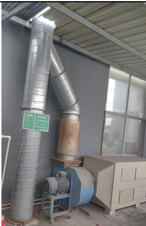
图 3-8 3#排气筒及排气筒标志牌照片
