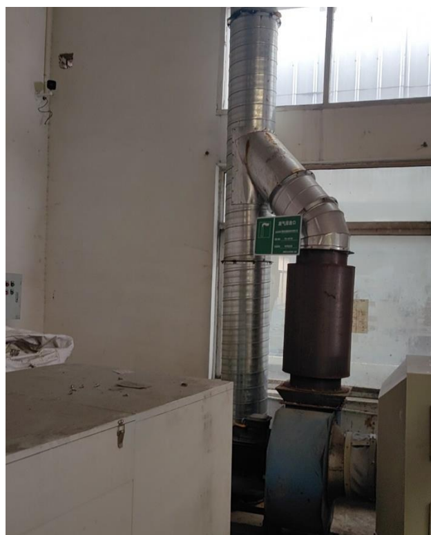
图 3-7 2#排气筒及排气筒标志牌照片
