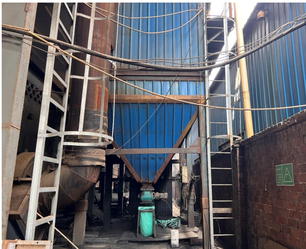
图 3-2 锅炉燃烧废气处理设施照片
